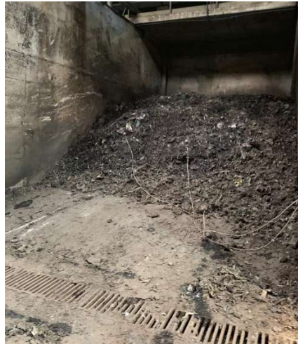
Intasamento delle canalette di raccolta percolato
